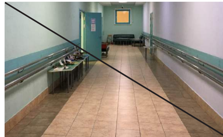
Плохо Керамогранитная плитка с крупными швами
